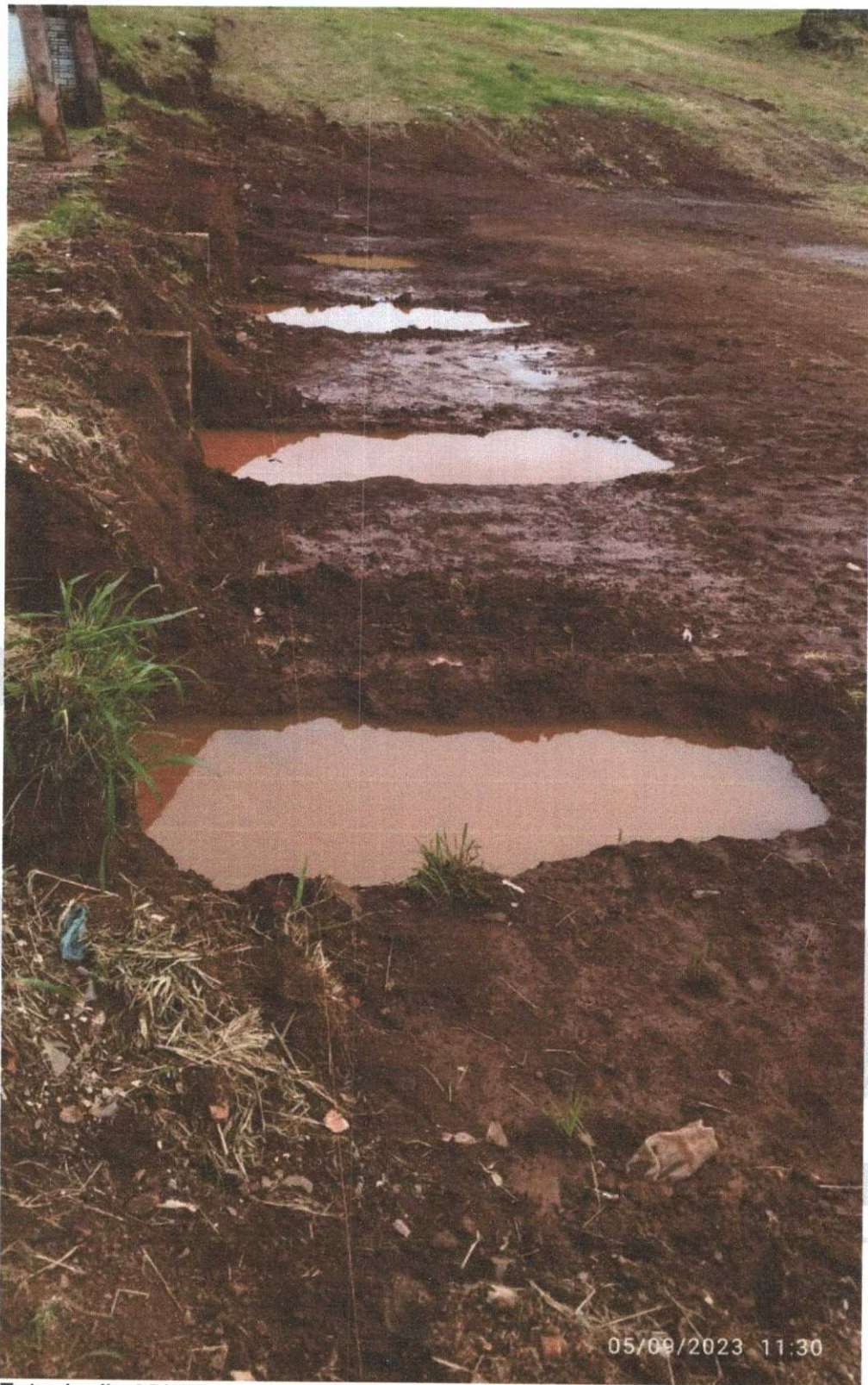
Foto do dia 05/09/2023, com a fundação da arquibancada alagada.
