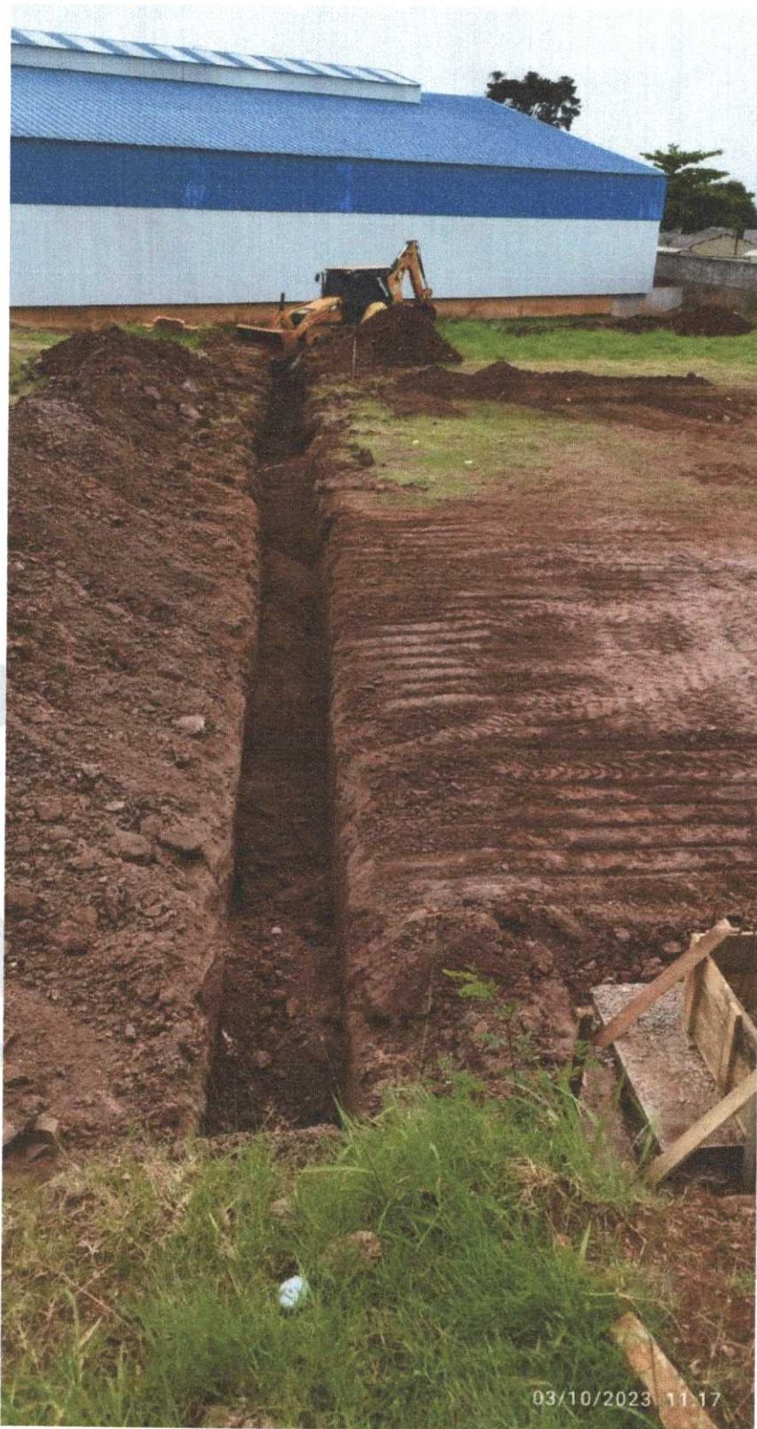
Foto do dia 03/10/23: abertura a vala para instalação dos tubos de concreto (serviço não medido até o momento).
