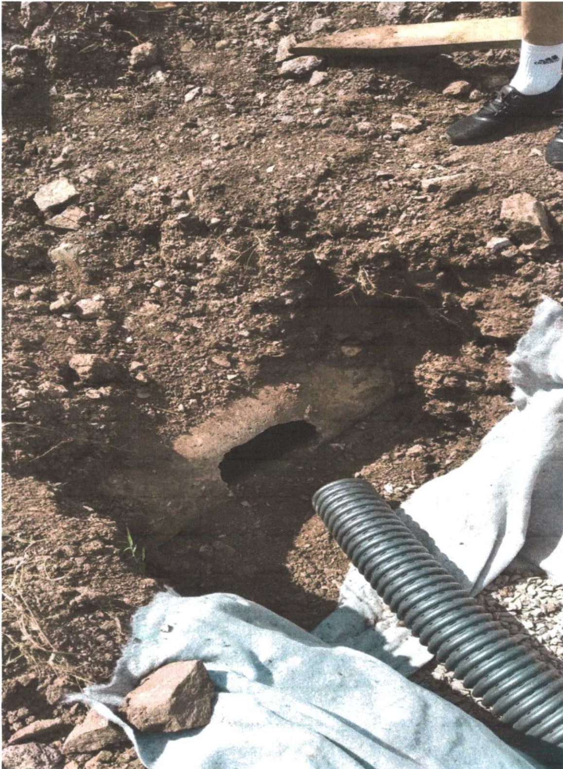
Foto 04: local onde deveria ser executado uma caixa de passagem
